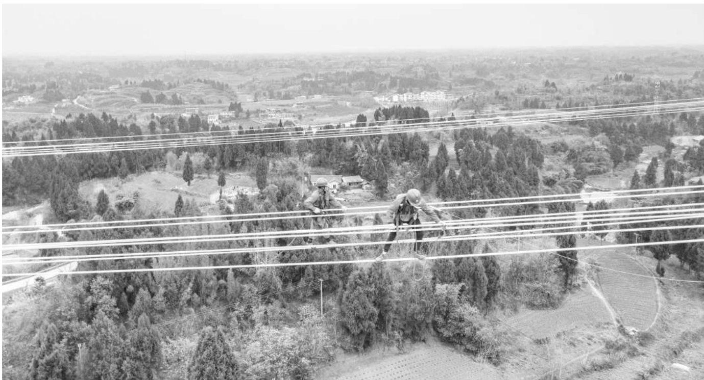
3月17日,施工人员在位于重庆市铜梁区少云镇的川渝1000千伏特高压交流工程施工现场作业。
