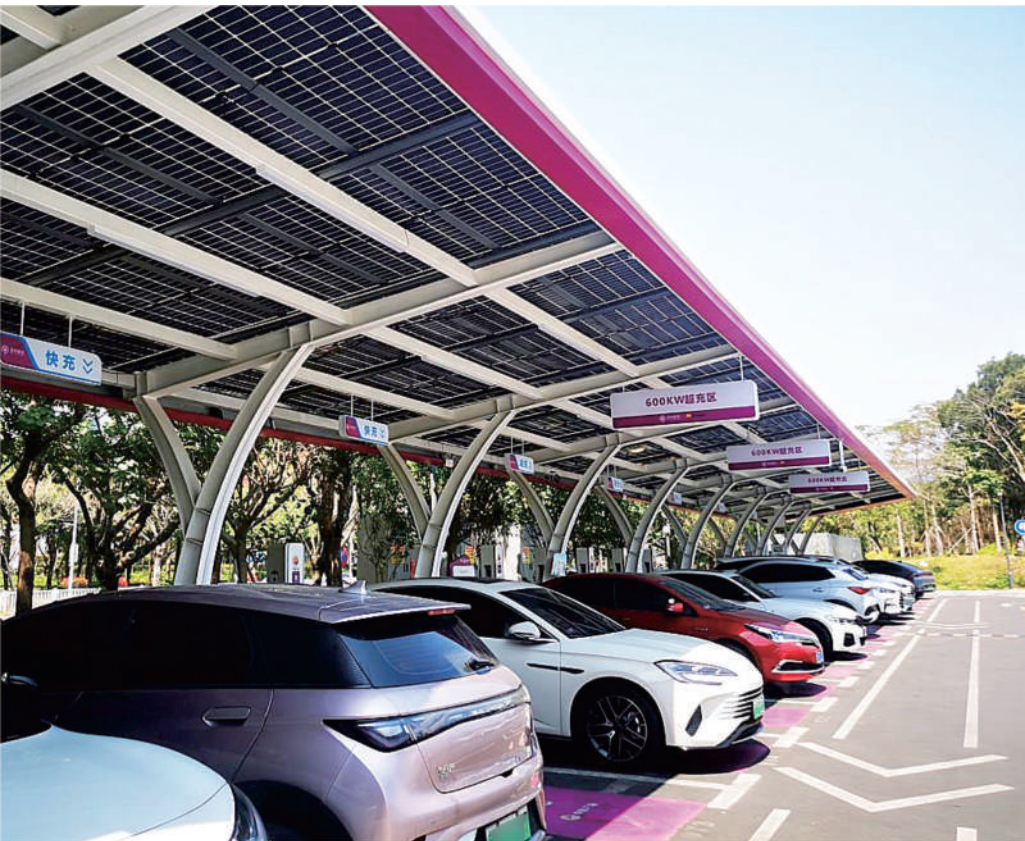
图为深圳笔架山光储超充站。 王明弘/摄
