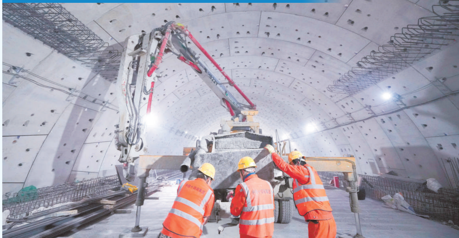
3月17日，山东济南，随着最后一块现浇车道板浇筑完成，济南黄岗路黄河隧道上层车道板全部完工，标志着世界最大直径水下盾构隧道实现双层贯通。图为施工人员浇筑现浇车道板。中新社发 肖雨/摄
