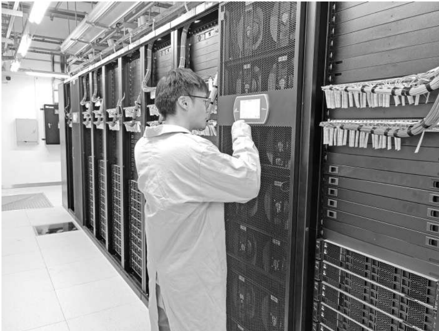
图为浙江移动数据中心,为用户提供算力服务。 时财财经图库/供图
