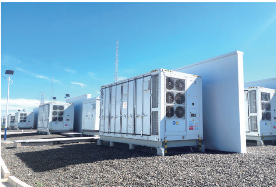
图为内蒙古泰鑫储储能电站。 刘灿邦/摄
