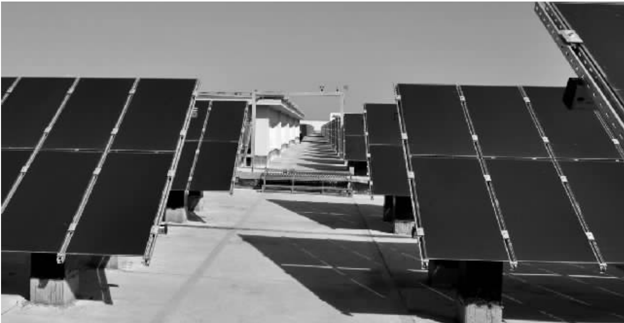
设于河南保绿能源屋顶 350kWh 电站采用的薄膜太阳能电池，技术及规划在业界均具指标性
