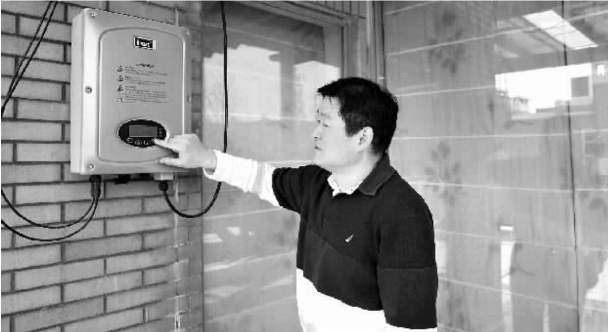
陈继霖向记者介绍光伏逆变器
