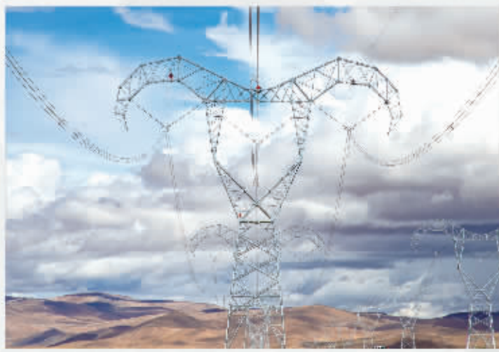
国家电网-阿里与藏中电网联网工程沿线500千伏岗巴羊头山景观塔。
